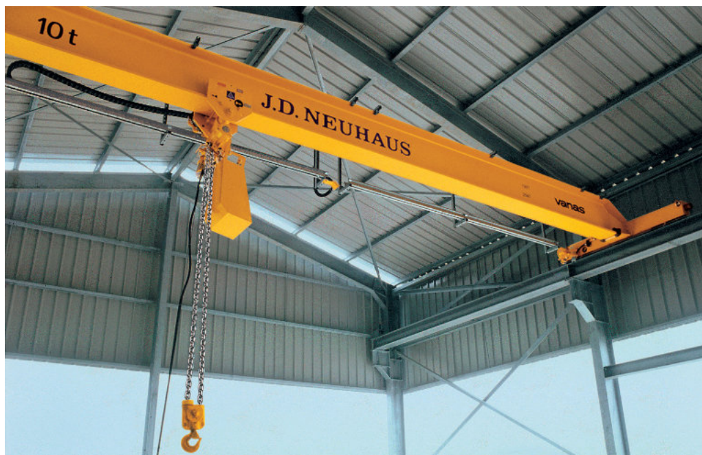
Carroponte monotrave pneumatico portata 10 t, scartamento 11 m. Air driven monorail bridge crane, WLL 10 t, span 11 m.
